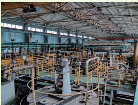
三氧化二砷生產設施
