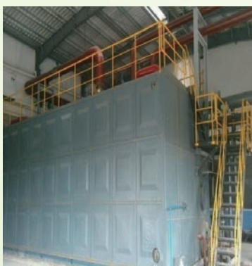
改造後的燃氣鍋爐
