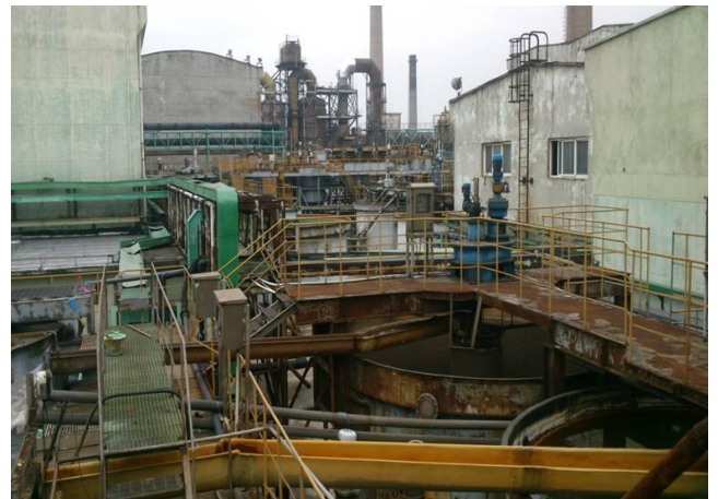
硫酸车间废水处理站
