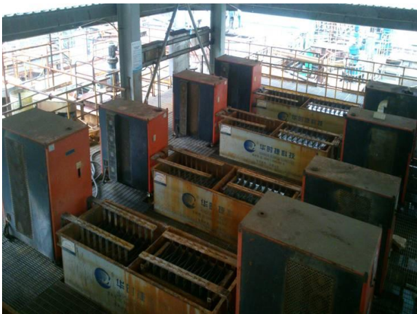
硫酸车间废水处理站
