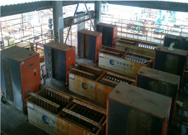
硫酸车间废水处理站
