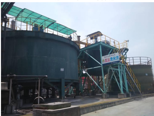
车间废水预处理设施
