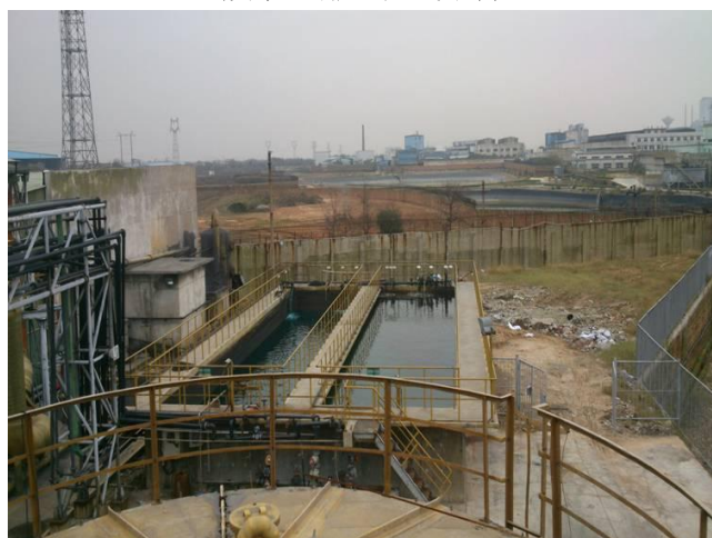
车间废水预处理设施
