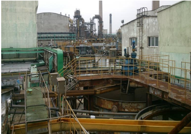
硫酸车间废水处理站
